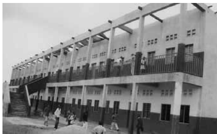
Mittelschule in St. Felix, Kinshasa (Kongo) das Dach wurde vom Sturm weggefegt.
